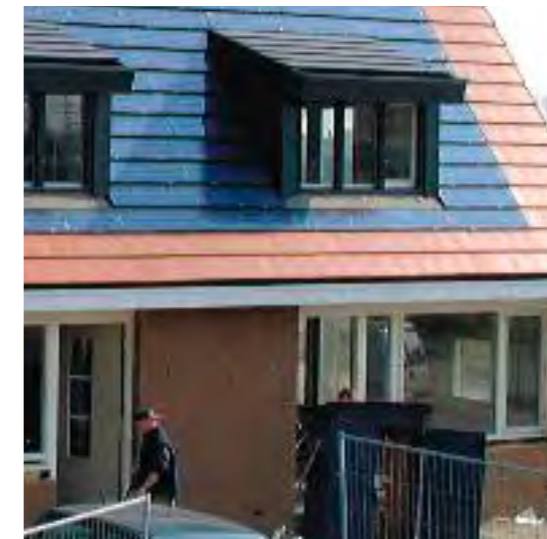
PV-cellen als film over een strook dakpannen.
