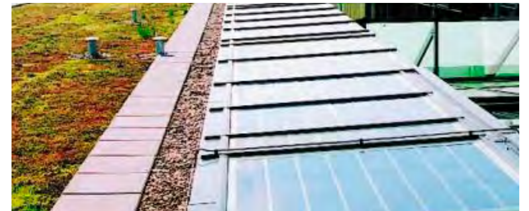
PV-panelen geïntegreerd in een daglichtstrook in het dakvlak.
