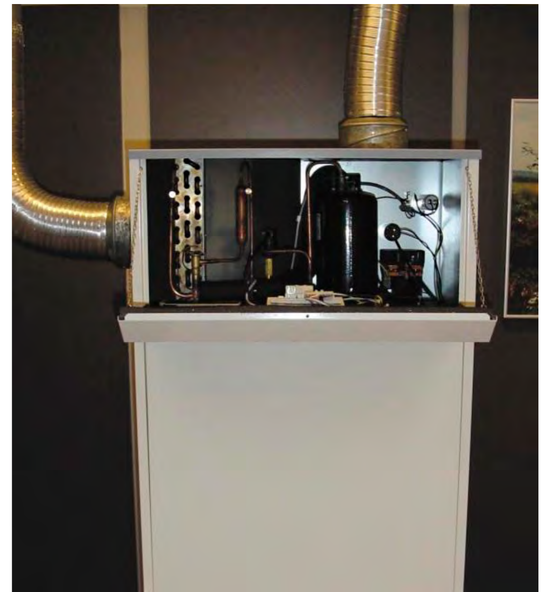
Een warmtepompboiler levert warmte ten behoeve van tapwaterverwarming.
