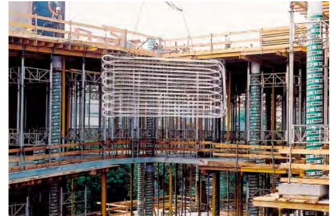
Betonkernactivering is een manier om via de constructie te koelen. Hier wordt het leidingennet geplaatst.
