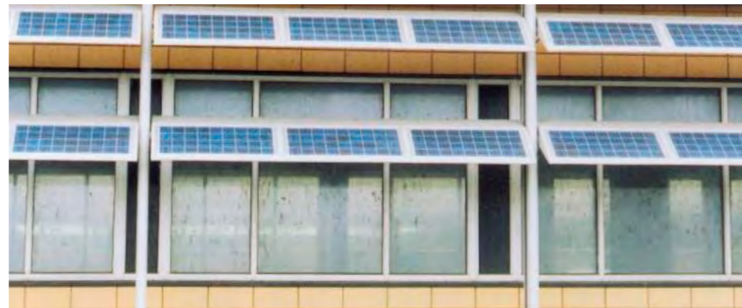
Een mooie manier om zonnecellen toe te passen is geïntegreerd in buitenzonwering.
