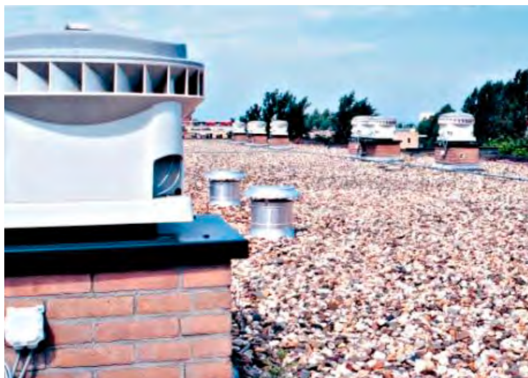
Bij mechanische ventilatie kan warmteterugwinning plaats vinden met behulp van een warmteterugwin-unit op het dak.
