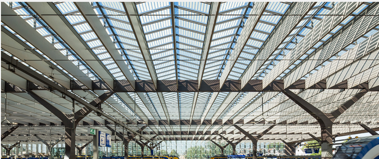
Afbeelding 9 Ongeschoord raamwerk in NS-station Rotterdam Centraal
