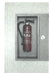
fire extinguisher de brandblusser
