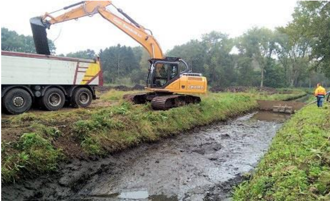
Figuur 38 Het vervuilde slib wordt door de gemeente Helmond in dit geval, afgevoerd. De gemeente kan op haar beurt de kosten middels een schadevergoeding verhalen, mits er sprake is van een onrechtmatige daad.
