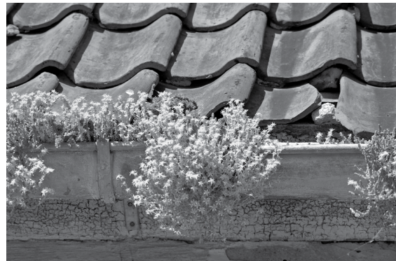
▼ Afb. 60 Besdragende planten in een dakgoot.
