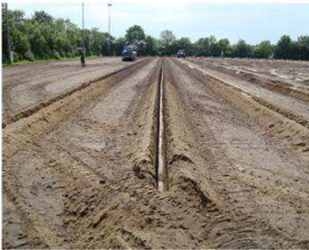
7. De drains liggen
