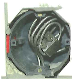
Fig.2 Het centrale aardpunt
