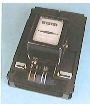
Fig.15 Aansluiting kWh-meter op meterbord
