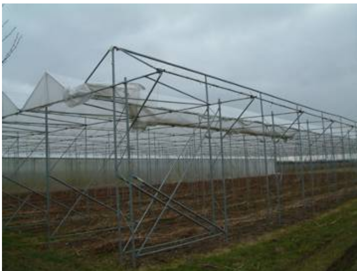
Foto 3: Overkappingstelsel met buisconstructie (Bron: Poldervaart, 2006)
