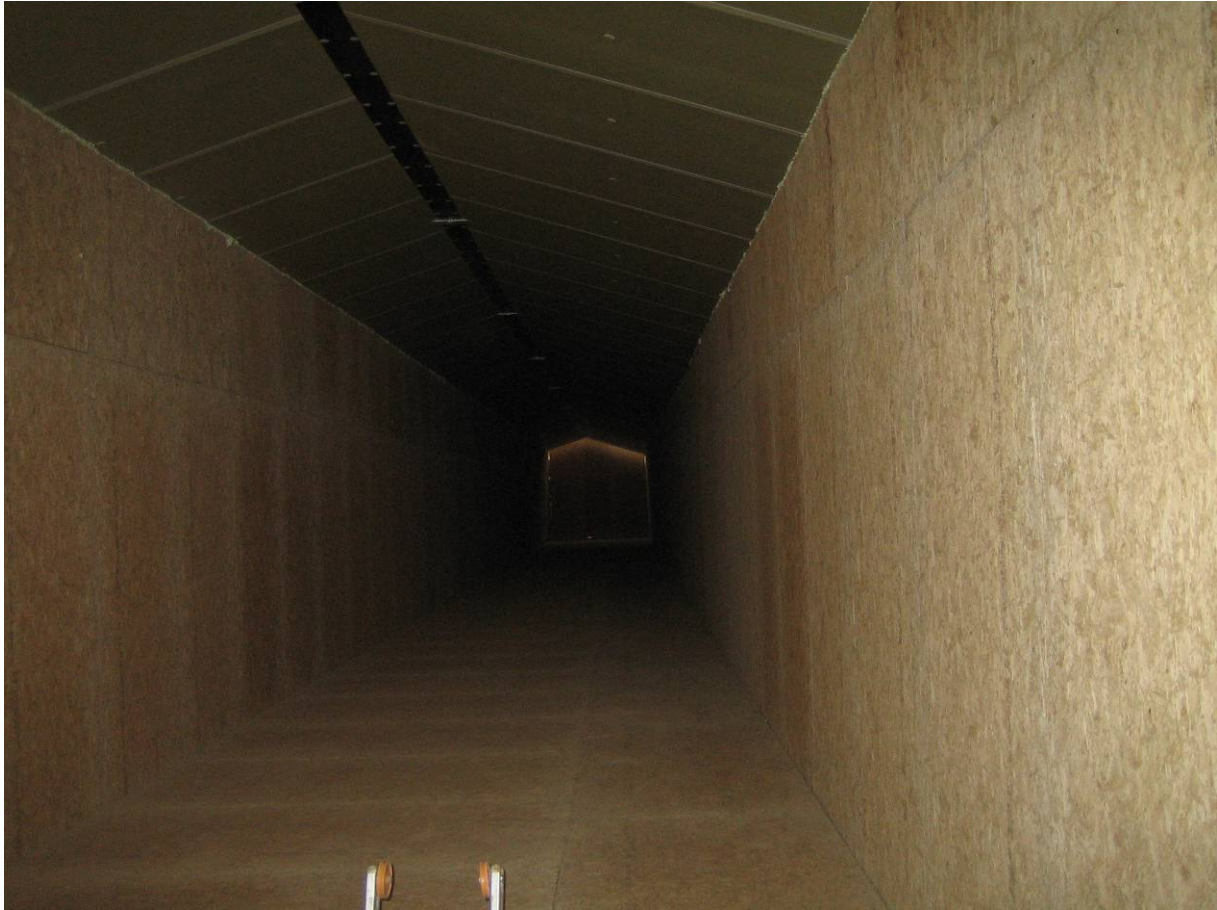
Figuur 39 Centraal afzuigkanaal
