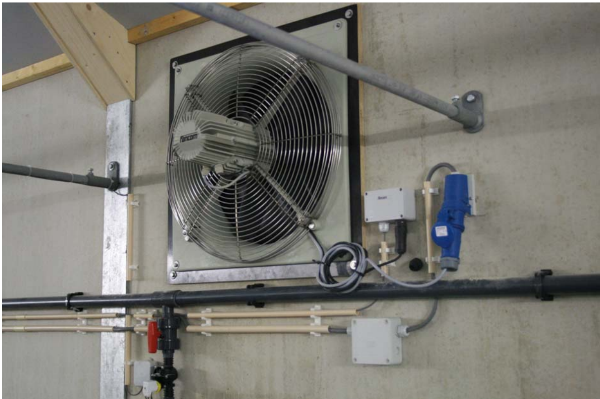
Figuur 44 Mengventilator in de afdelingswand
