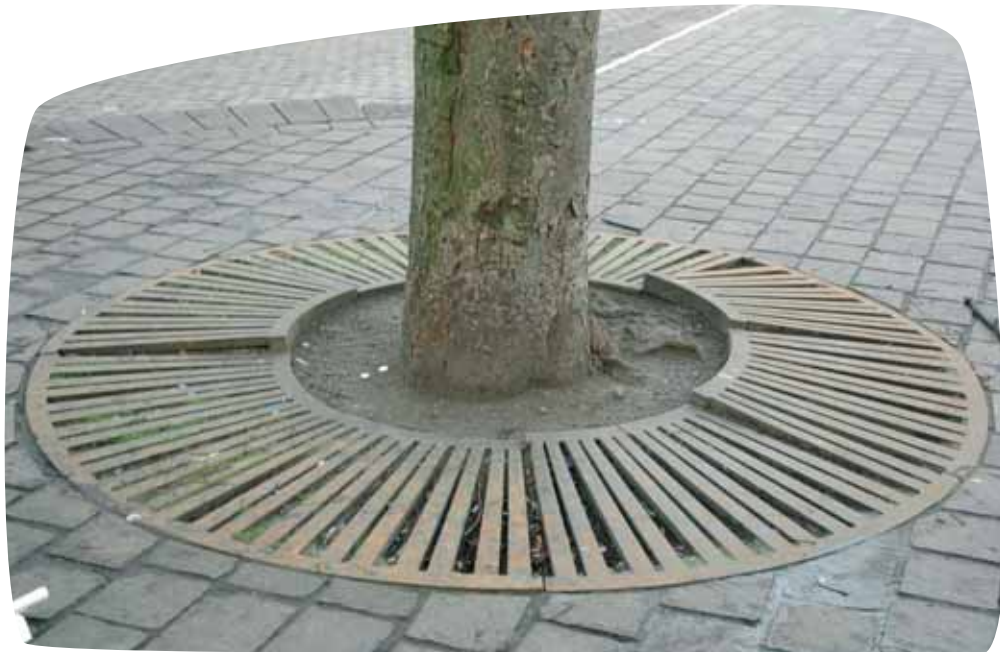
Een boomrooster wordt door de diktegroei van de boom soms opgeduwd, met gevaarlijke situaties tot gevolg.
